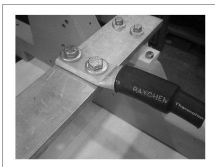
FIGURA 27. CORRETTO FISSAGGIO DEI CAVI
