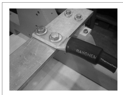
FIGURA 27. SUJECCIÓN CORRECTA DE CABLES
